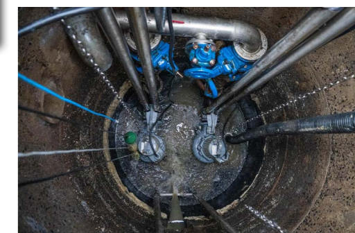
Poste de relevage
