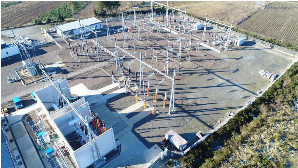
Vue d'un poste source électrique
